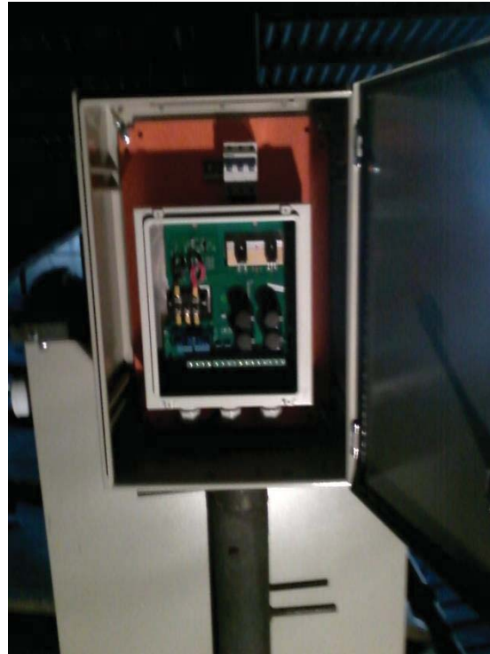
Figura 2-24: Gabinete con el equipo controlador
