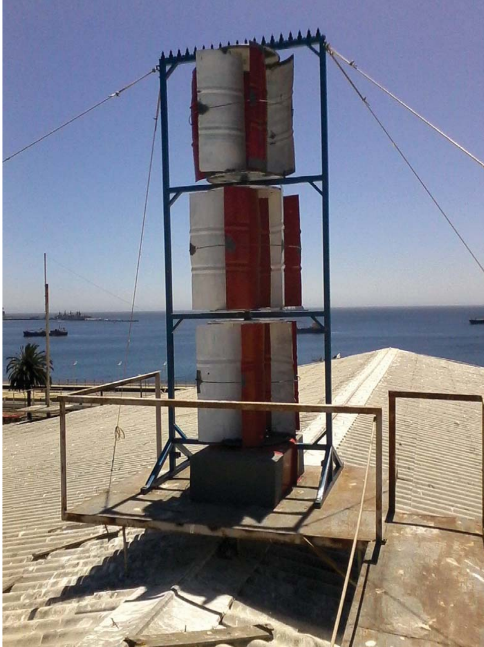
Figura 2-26: Sistema eólico terminado
