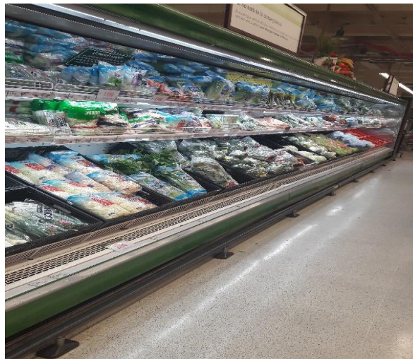
Figura 4-5: Mostrador con tres líneas de tubos fluorescentes (Fuente: Elaboración propia)
