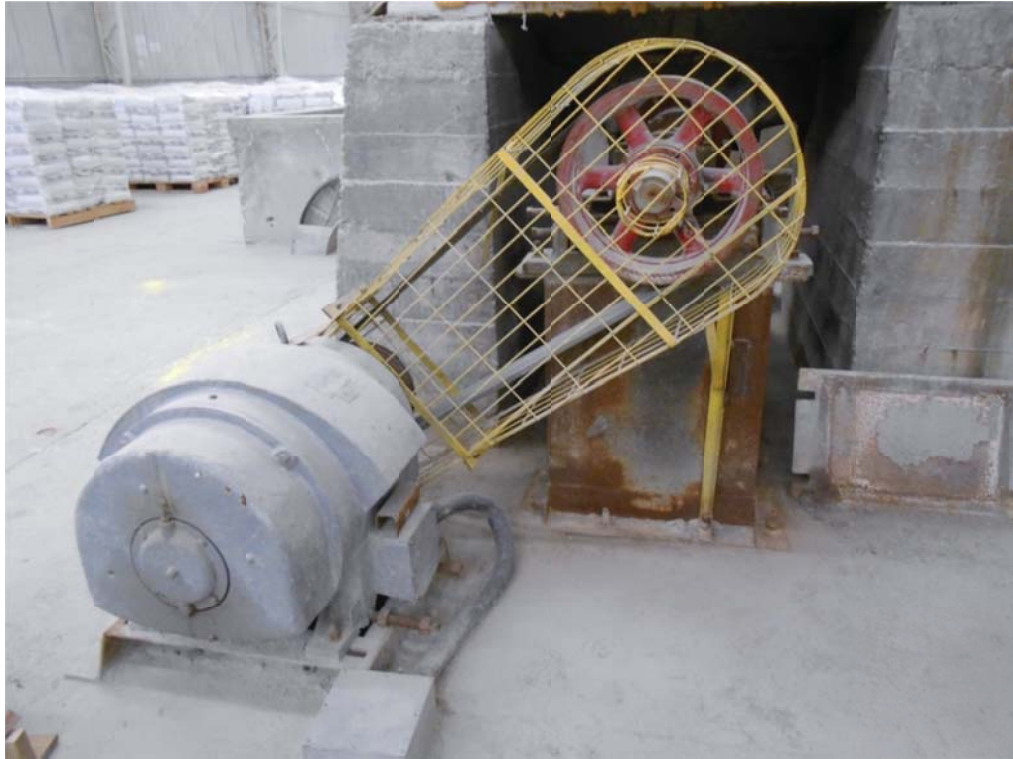
Fig. 14: Fotografía del motor eléctrico, correas, polea y protección de correas.
