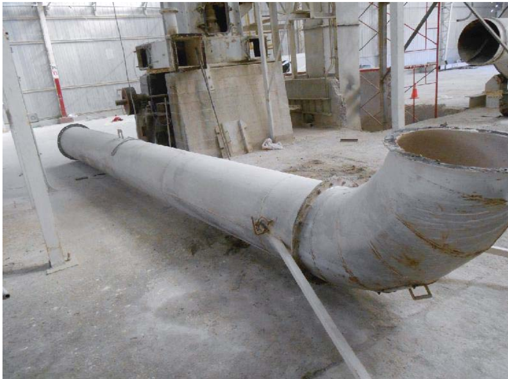
Fig. 59: Ducto ciclón - ventilador desconectado.
