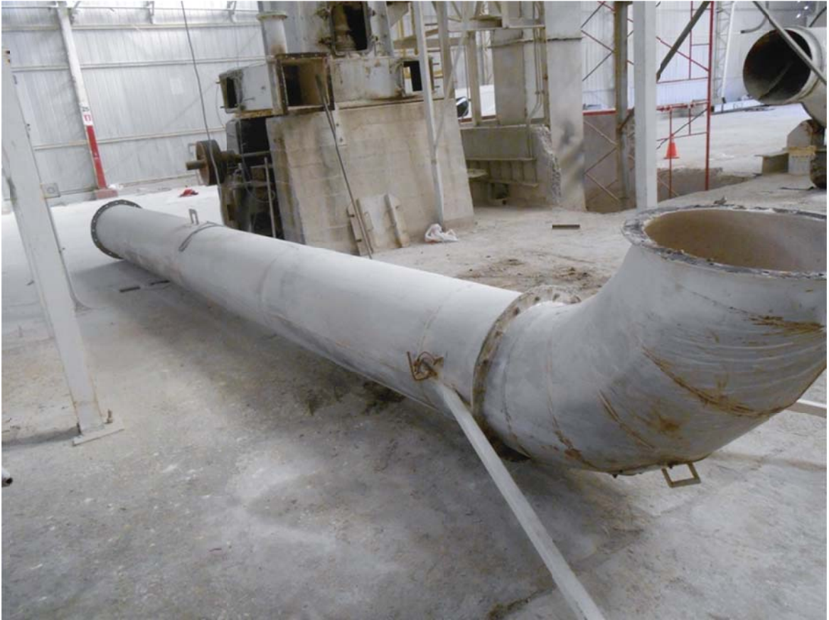
Fig. 19: Cañería existe entre ciclón – ventilador centrífugo desmontada.
