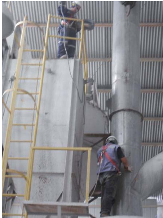
Fig. 67: Personal realizando actividades en ducto de seguridad.
