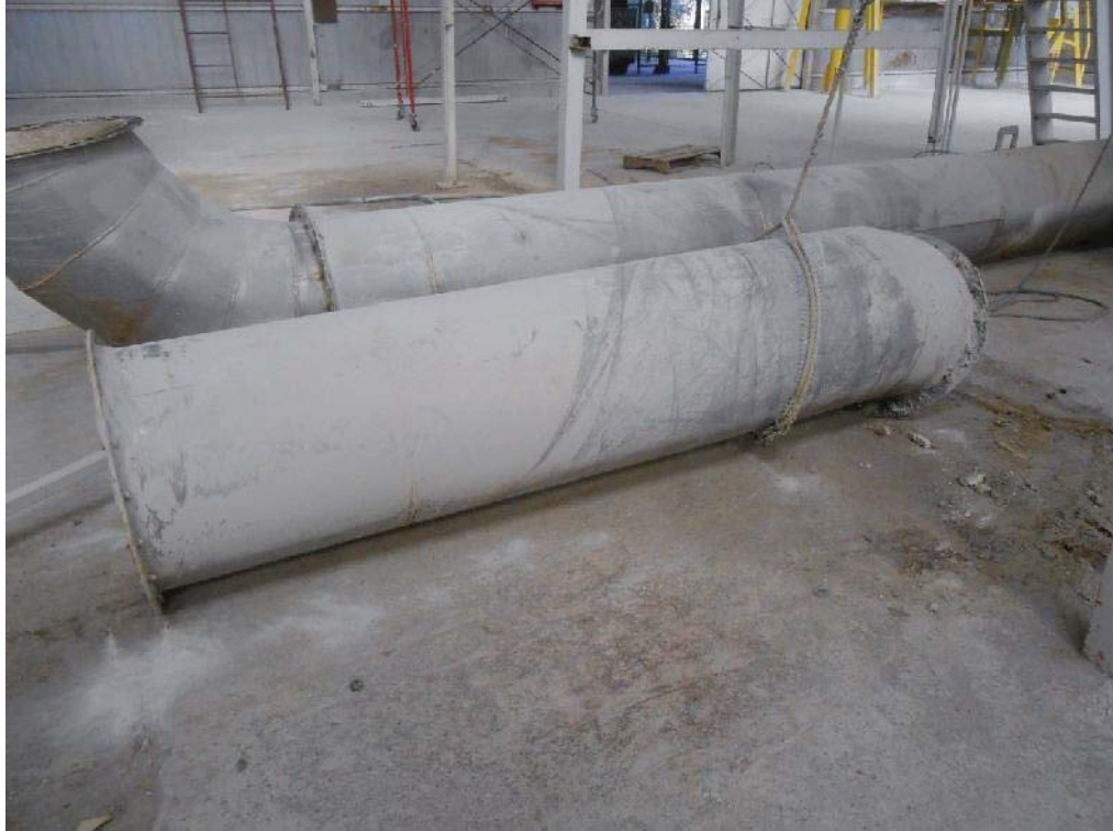
Fig. 62: Ductos molino – ciclón desconectados.
