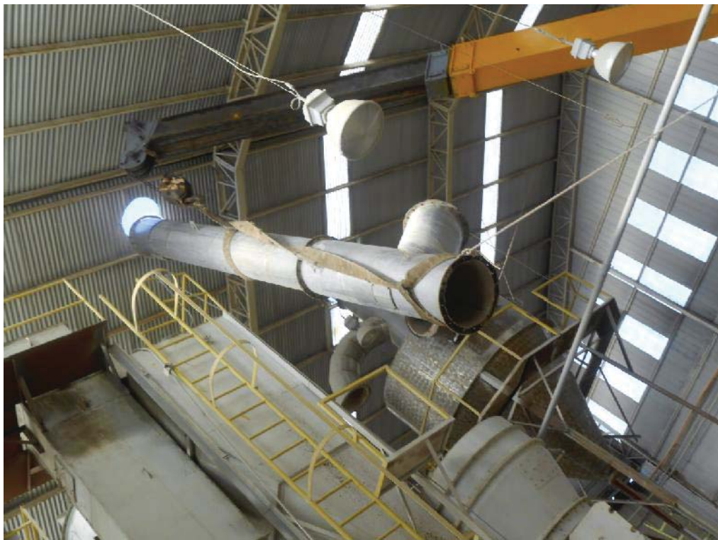
Fig. 71: Descendiendo ducto de seguridad.
