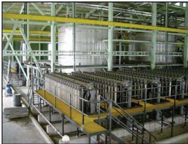
Figura 2.11: Planta industrial de celdas EMEW ®
