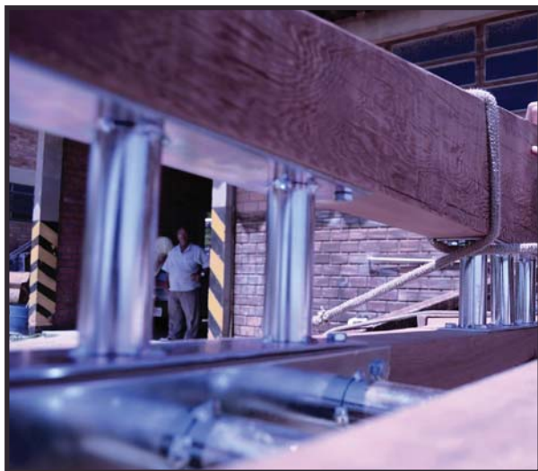
Uniones de acero galvanizado
