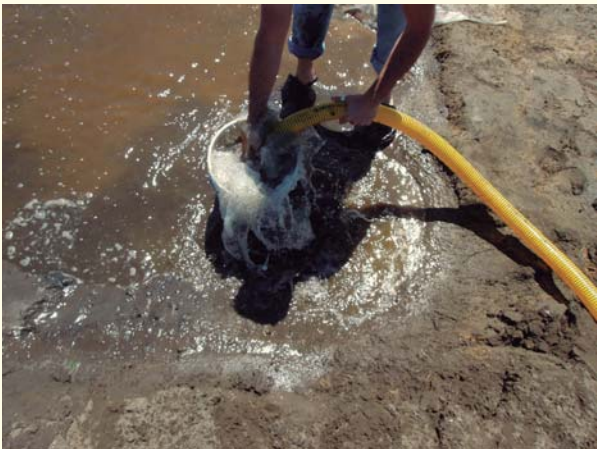
Recepción de agua con tacho para evitar socavamiento de la arena
