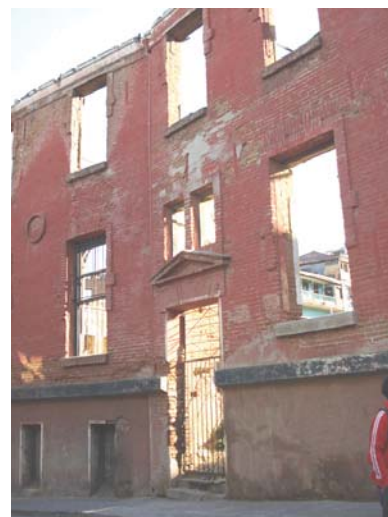
muro perimetral conservado, tipología de los vanos que se conservo para nuevo acceso
