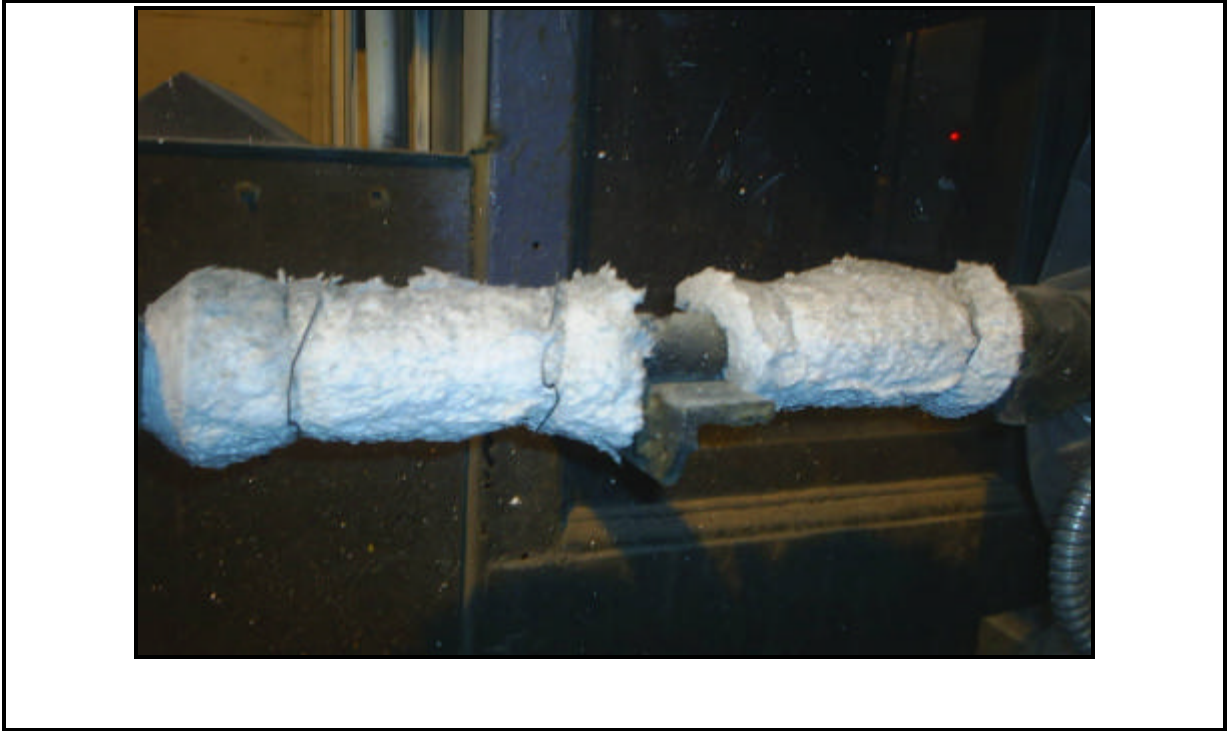
Figura 4.2: Aislación circuito de cañerías de transporte de Enap-6.
