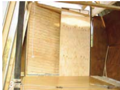
1.-abertura muro armario 2.- aislación interna: poliestireno expandido 3.- revestimiento terminado, imagen de interior vestido, pile blanda que retiene en el no límite visual
