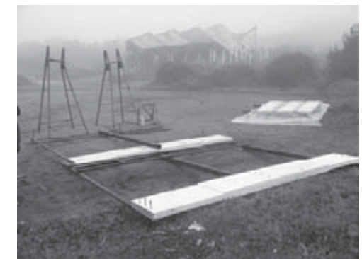
lo que se recibe: dos paneles armados de la estructura primaria y dos por armar.
