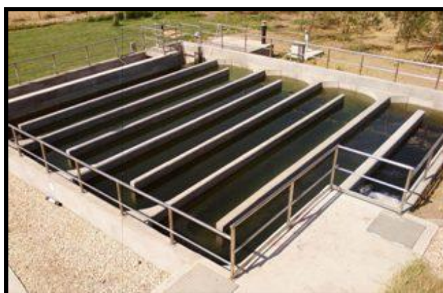
Figura 4.12 Cámara de contacto PTAS Til-Til.
