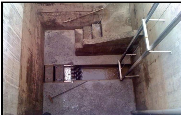
Figura 4.1 Planta elevadora, PTAS Curacaví.
