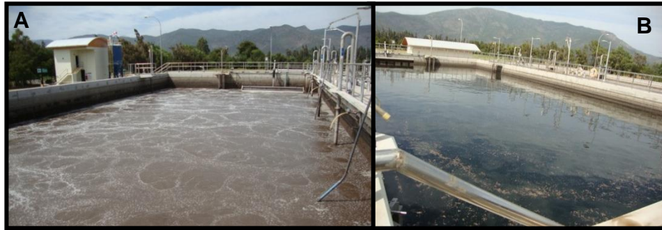
Figura 4.7 A) SBR 1 en etapa de aireación y B) SBR 2 en etapa de sedimentación, PTAS El Monte.
