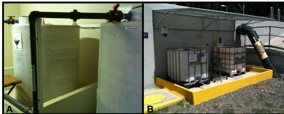
Figura 4.17 A) Estanques de hipoclorito en sala de cloración y B) Estanques de antiespumante bajo techo, PTAS Curacaví.
