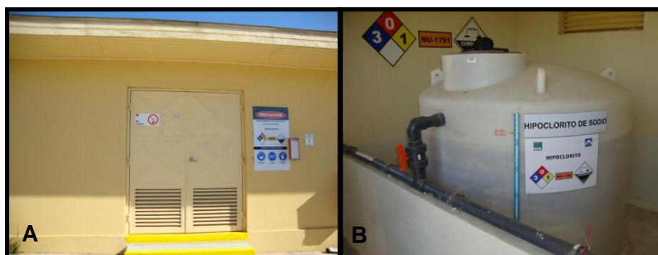
Figura 4.11 A) Sala de cloración y B) Estanque de hipoclorito de sodio, PTAS Til-Til.
