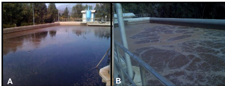
Figura 4.6 A) SBR 1 en etapa de sedimentación y B) SBR 2 en etapa de aireación, PTAS Curacaví.
