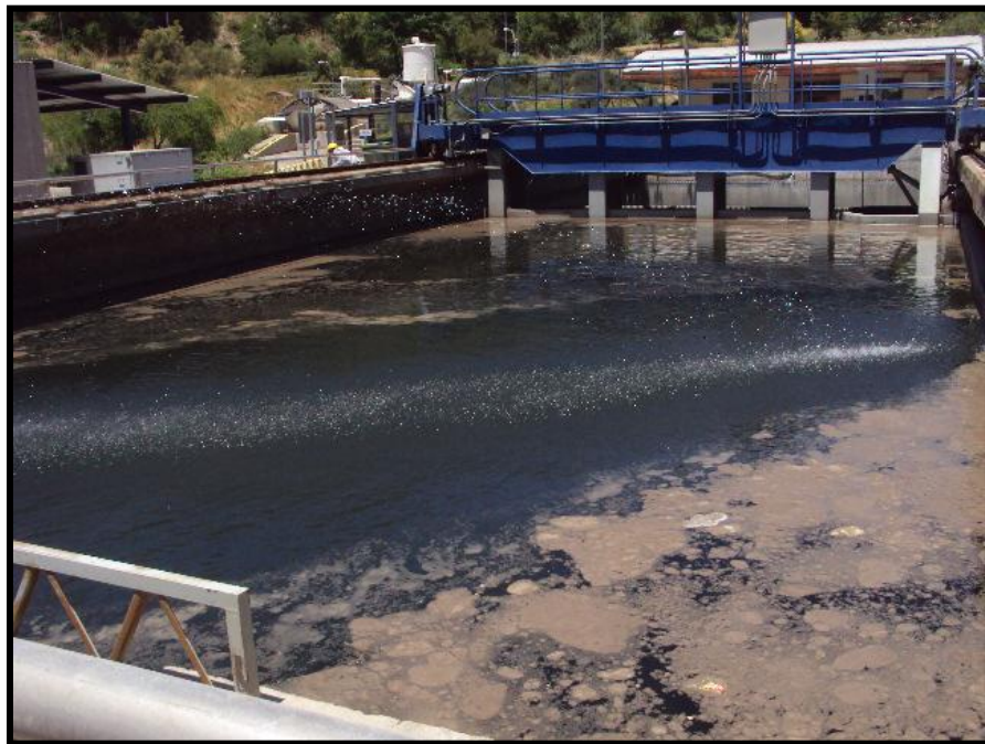
Figura 4.5 Clarificador con puente barredor de lodos, San José de Maipo.
