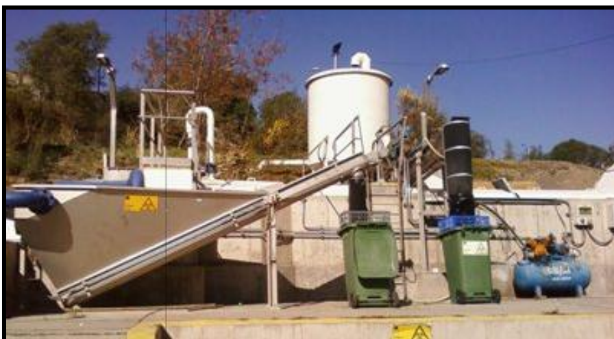
Figura 4.2 Tratamiento preliminar de San José de Maipo, se encuentra sellado para evitar emisión de malos olores.
