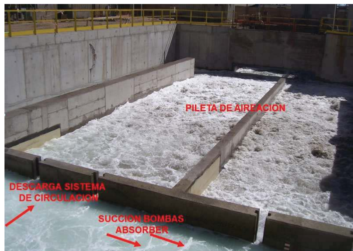
Figura 9. Planta de tratamiento de agua en servicio.
