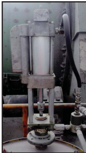
Figura 27: Fotografía Bomba Hidráulica – Fuente: CMCN.
