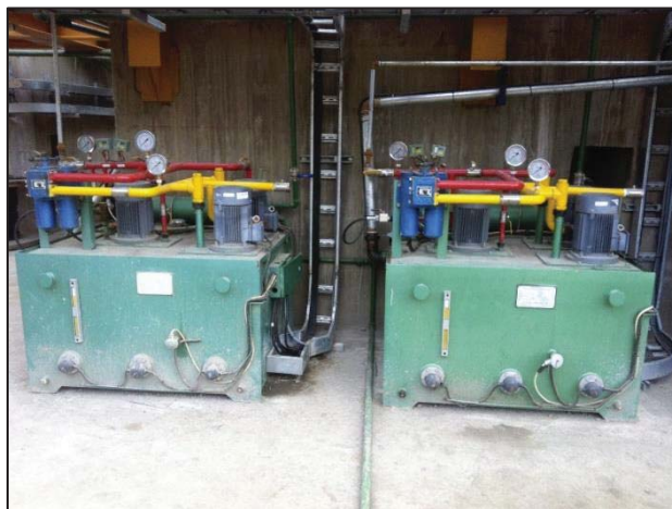
Figura 21: Fotografía Bombas de Alta y Baja Presión – Fuente: CMCN.
