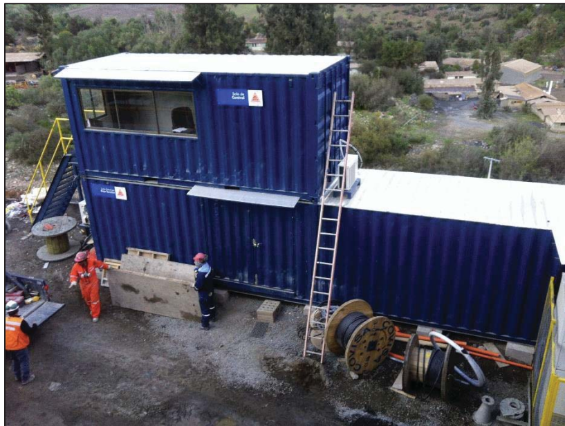
Figura 24: Fotografía Sala de Media Tensión y Sala de Control – Fuente: CMCN.
