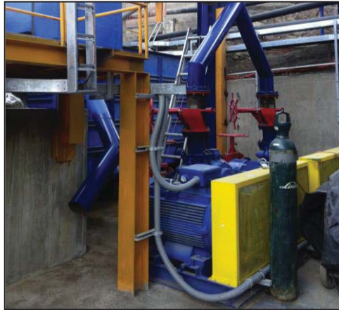
Figura 29: Fotografía Bombas de los Hidrociclones Instaladas – Fuente: CMCN.
