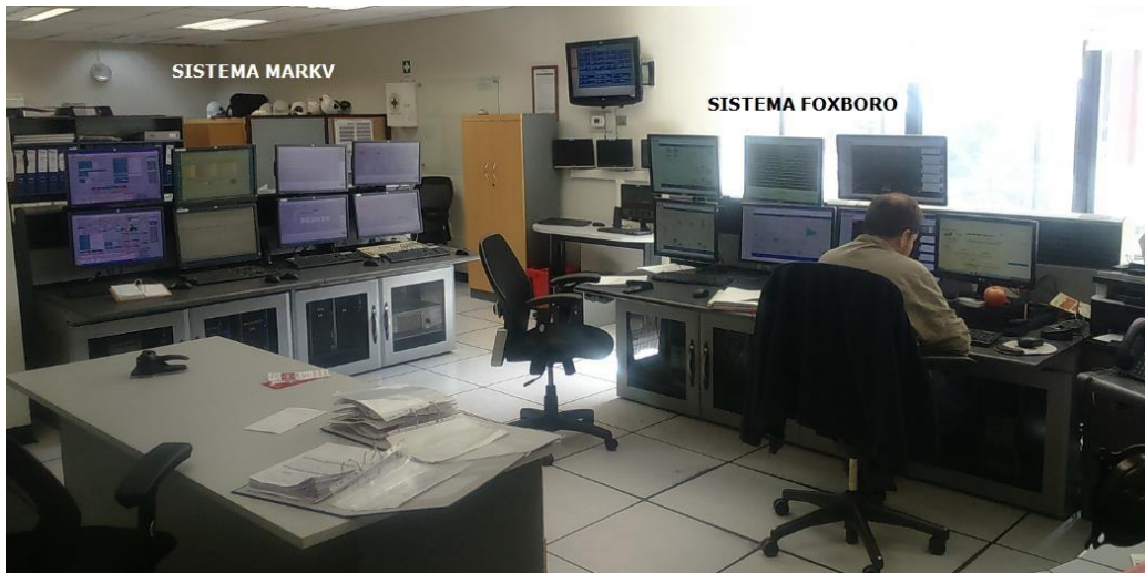
Figura 3: Sistemas de control distribuido Mark V y Foxboro en Central Nueva Renca
