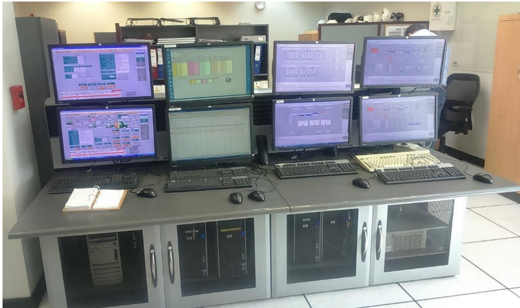
Figura 9: Sistema de Control de Turbina de Gas Mark V Central Nueva Renca.
