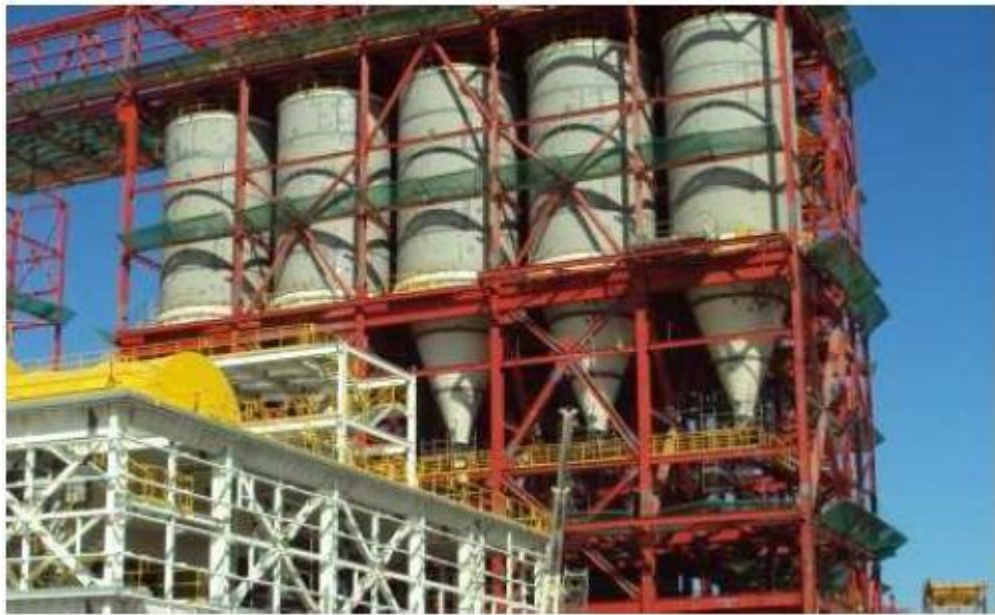
Figura 106: Distribución de los cinco silos que cuenta cada unidad de Central Angamos
