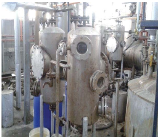
Ilustración 9: Separador de reactor #2
