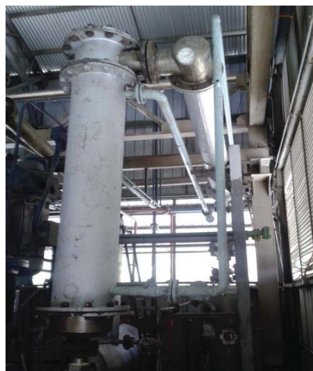
Ilustración 10: Condensador vertical y horizontal del reactor #1
