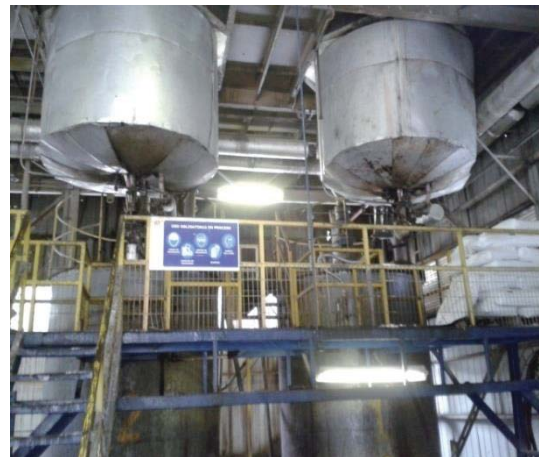
Ilustración 6: Parte inferior reactores #1 y #2
