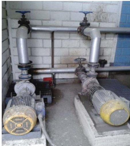
Ilustración 14: Bombas de fluido térmico
