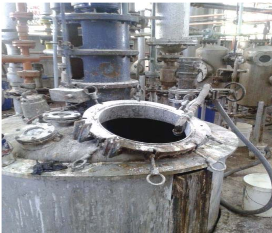
Ilustración 5: Parte superior reactor #5
