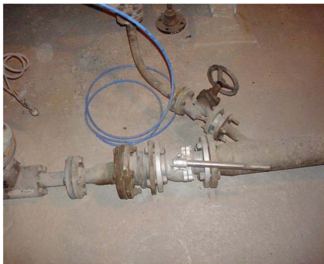
Figura 27: Tarea finalizada mantención Mecánica.
