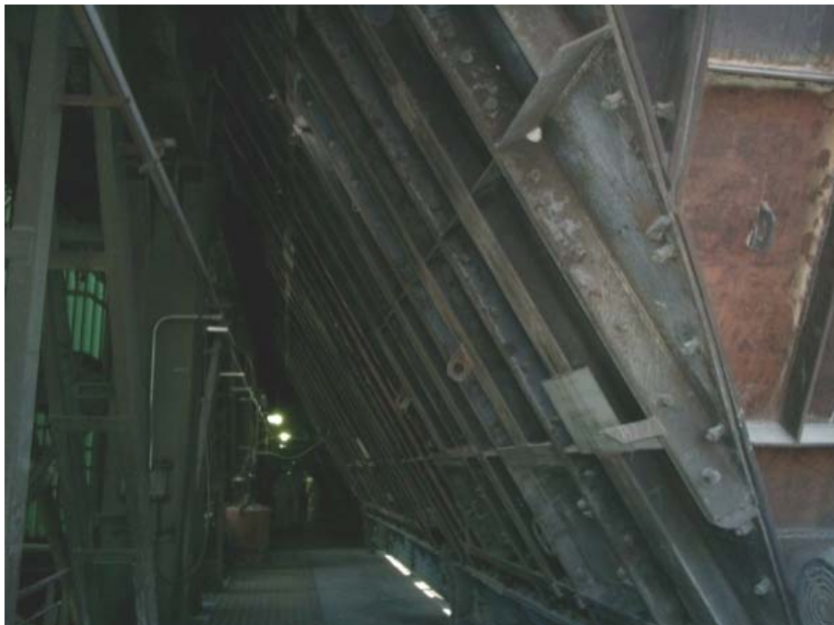
Fig. 2.4 Vista lateral cámara enfriamiento.
