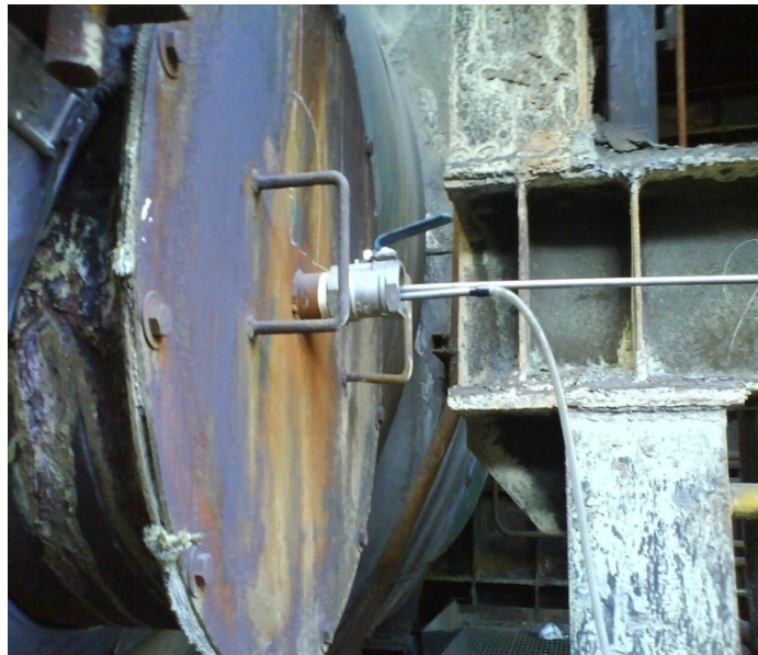
Fig. A.8.5 Fotografía Tapa Salida Cámara Enfriamiento Radiativa
