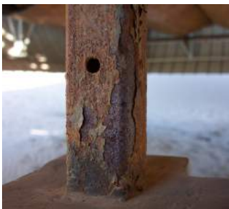
fuerte oxidación en pendulos del suelo.
