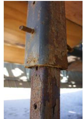
mantención a todos los elementos en oxidación.
