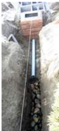
Salida desde la cámara decantadora al dren.
