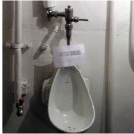
artefactos baño con sistema de agua.
