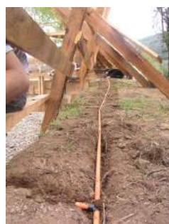
trazado de conduit por estructura.
