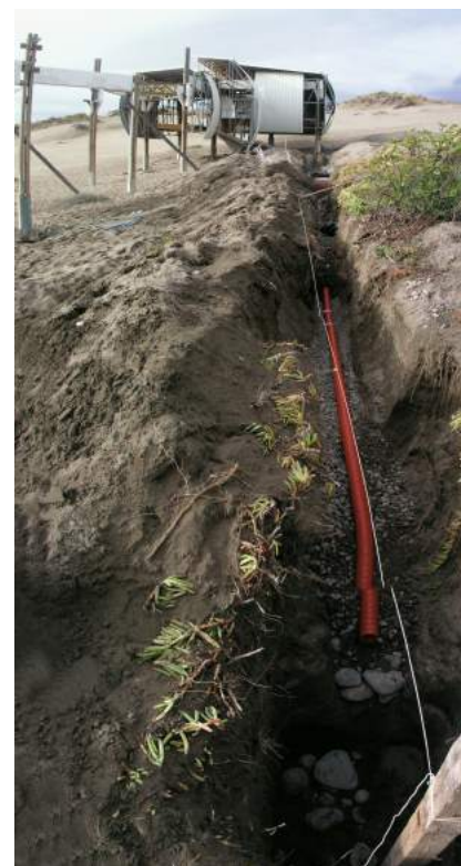
trayecto del drenaje desde la hospedería.
