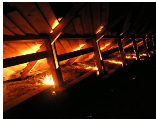
ubicacion de las ampolletas en las bancas.
