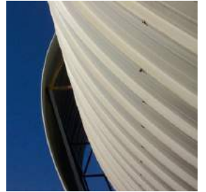
curbaturas cubierta metalicat.
