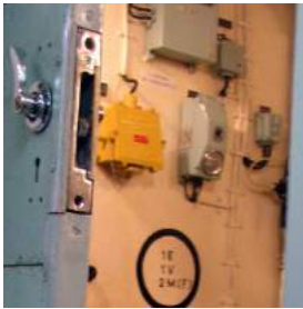
sistemas de seguridad.
